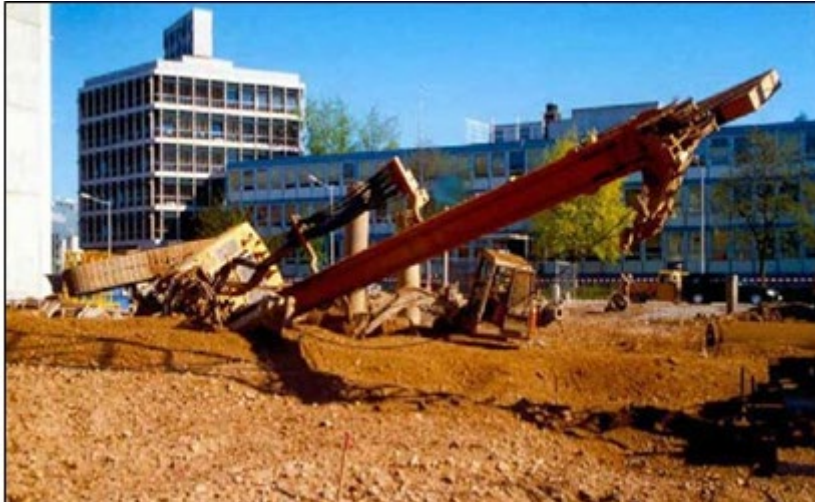
Abbildung 2 bei Bohrarbeiten 5-Zenter-Bombe angebohrt
