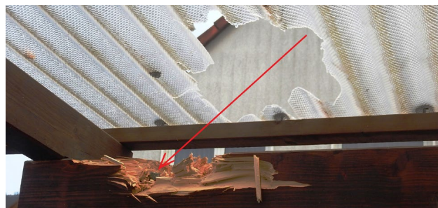
Detail „Einschlagstelle“ Vordach (Quelle: RP Darmstadt)
