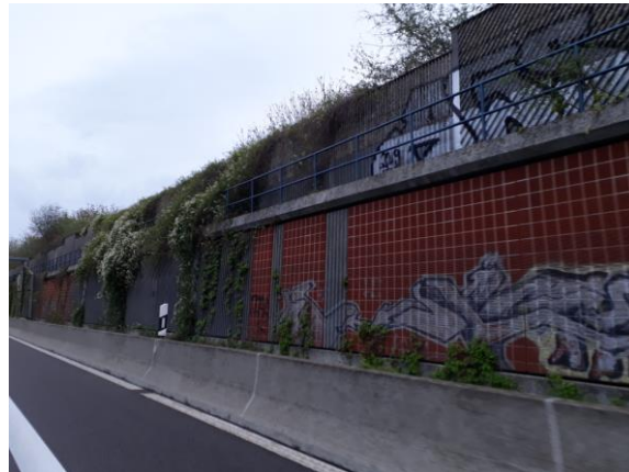
Abbildung 123: Lärmschutzwand an der B 45 im Bereich Weiskirchen, © Regierungspräsidium Darmstadt
