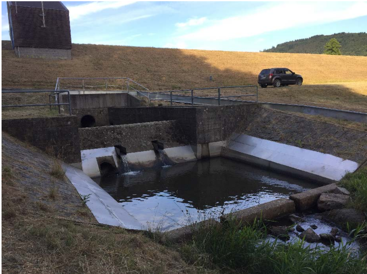
Abbildung 5: Kriebssperre am HRB Krumbach. Rostfreie Blechverkleidung am Tosbecken als Auskriechsperrre (Wasserweg). Die als zweite Sperre am Auslaufrohr des Betriebsüberlaufs (Bildhintergrund) installierte, überkragende V2A-Rohrrippe ist im Bild gerade eben nicht mehr sichtbar. Im Hintergrund das Amphibienleitsystem, das den Landweg sperrt. (Photo R. Hennings, IMG_1049, 9.7.2015)
