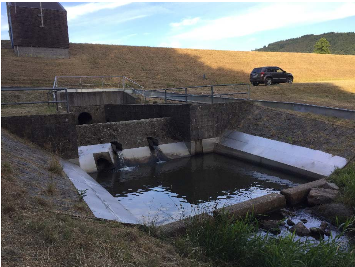
Abbildung 6: Rostfreie Blechverkleidung am Tosbecken des HRB Krumbach als Auskriechsperre (Wasserweg). Die als zweite Sperre am Auslaufrohr des Betriebsüberlaufs (Bildhintergrund) installierte, überkragende V2A-Rohrrippe ist im Bild gerade eben nicht mehr sichtbar. Dieses Bauwerk ist ungleich komplexer als das HRB Bockenrod. Rechts im Bildhintergrund die Amphibienleitbleche der Landwegssperre. Diese verursachte den Großteil der Kosten. Photo R. Hennings, IMG_1049, 9.7.2018
